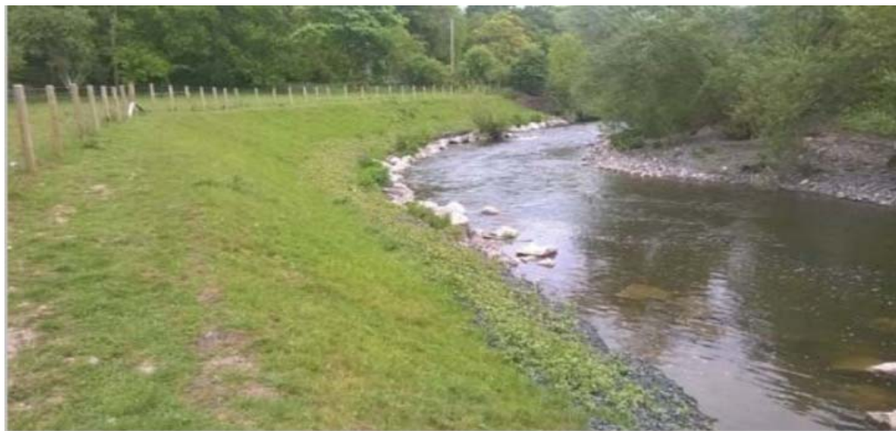
Figura 21 Breg të rigraduar me dyshekë të përforcuar me dheun dhe me gurë në shputën e bregut.
