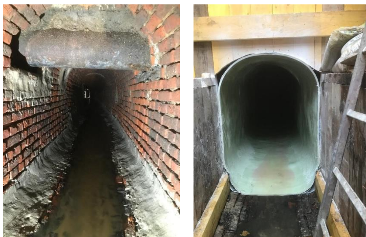
Figura 10 a), b). Gjendja e kanalizimit para dhe pas rinovimit me tub të palosur, Lille (Bretschneider, 2023)
