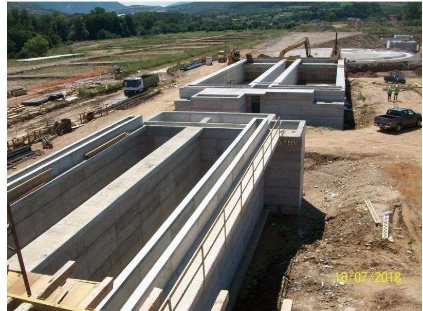
Punët në përfundim të strukturave të betonit (ndarësi i yndyrave dhe vajrave si dhe sedimentuesi primar)
